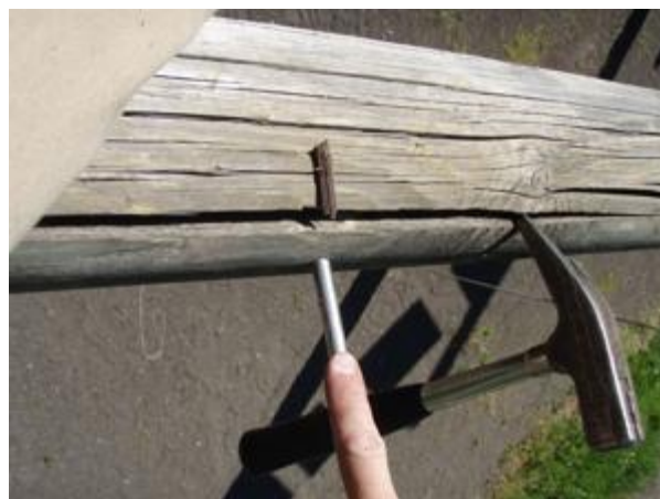
Abb. 4: Der Teil des Durchschlag-Werkzeugs, der nicht von dem Finger bedeckt ist, zeigt an, wie tief sich das Werkzeug in das horizontal installierte Rundholz einschlagen ließ. Auch wenn das Holz von außen sehr trocken scheint, wurde im Kern extrem feuchtes Holz (siehe tiefdunkles Holzstück) entdeckt.
