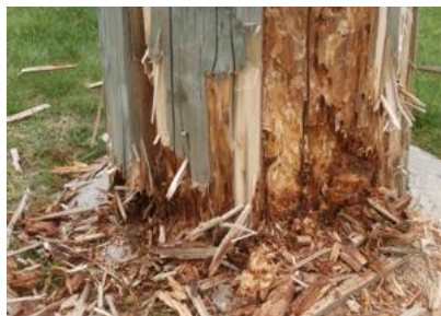
Abb. 2: Fäulnis im Inneren des Mastes wurde entdeckt nachdem Teile der härteren Außenhülle entfernt wurden.
